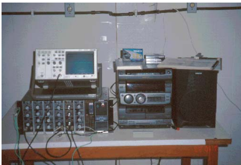
Figura 7. Detalhe dos equipamentos de gravação instalados no galpão da UEB.
