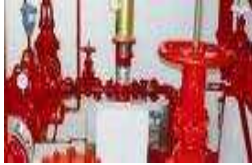
Fig. 8: Rede de Incêndio
