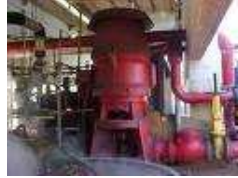
Fig. 13: Bomba de Incêndio
