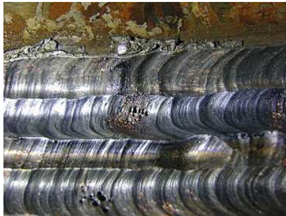
Figura 10 Descontinuidade detectada por ensaio visual em cordão de solda
