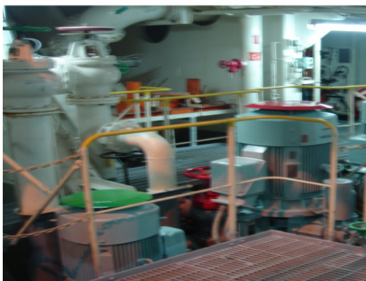
Figura 8: Bombas de circulação de água salgada Fonte: Foto do autor.
