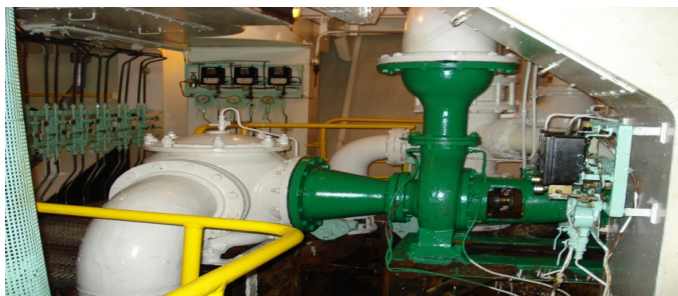
Figura 11: Bomba de lastro. / Fonte: Foto do autor.
