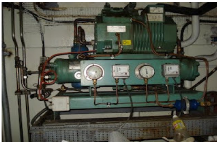
Figura 10: Compressores do sistema de refrigeração Fonte: Rould industria, 2009.
