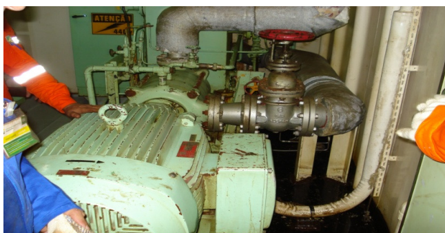
Figura 12: Bomba de incêndio. Fonte: Foto do autor.
