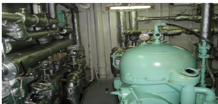
Figura 6: Compartimento dos separadores centrífugos de óleo combustível. Fonte: Foto do autor.
