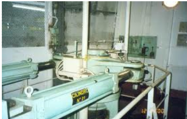
Figura 4: Unidade maquina do leme. / Fonte: Arquivo pessoal.
