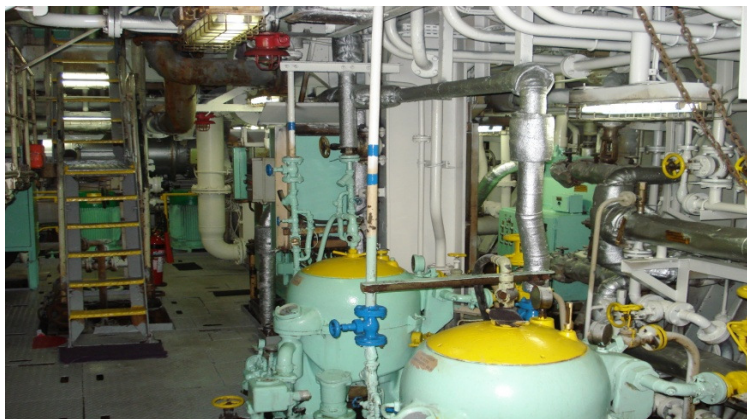
Figura 7: Compartimento dos separadores centrífugos de óleo lubrificante. Fonte: Fotos do autor.
