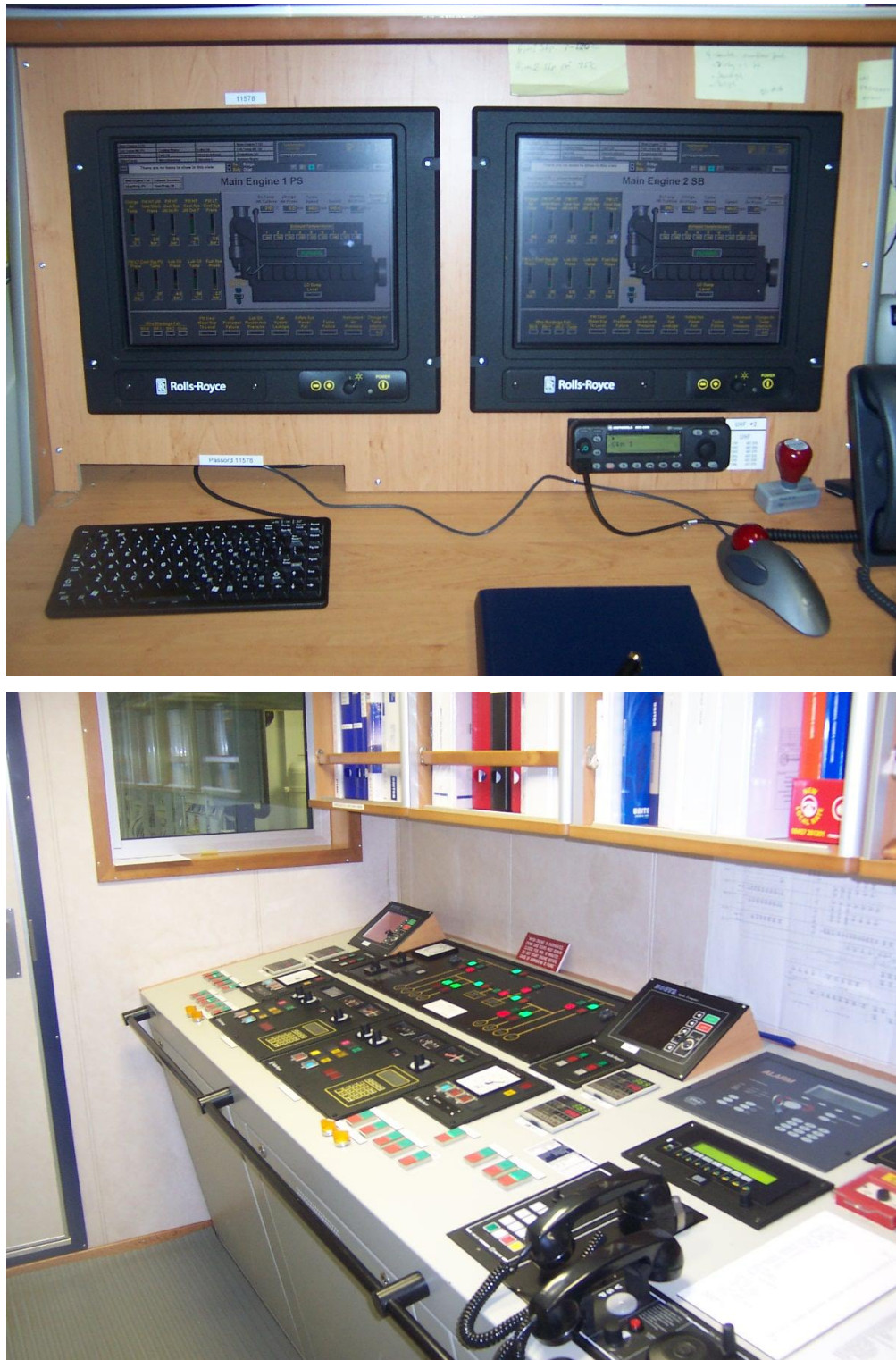
Figura 6.2 – Sala de controle e monitorização de uma praça de máquinas, exemplo de SCADA
