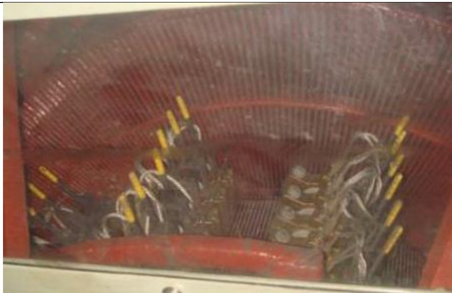
Figura 4-Janela de Inspeção do Motor de Propulsão do Rebocador: Richard M. Currance, com visão das escovas.
