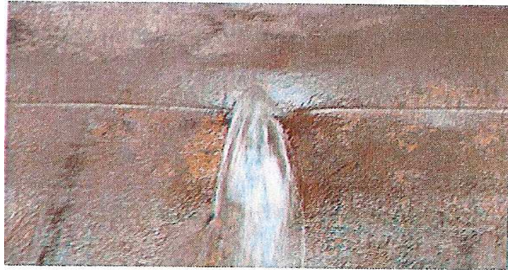
Figura 11: Aluimento na costura da chapa causando alagamento no porão.
