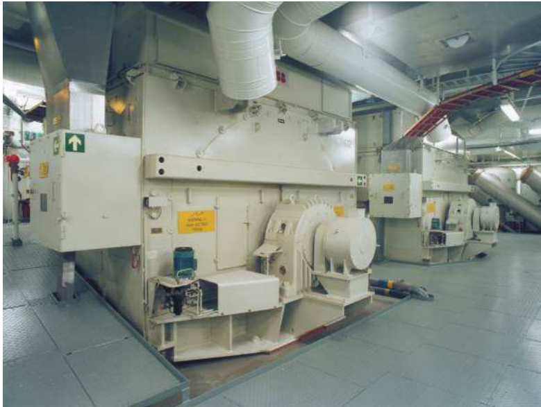
Fig.4 – Geradores ABB de um navio de passageiros.
