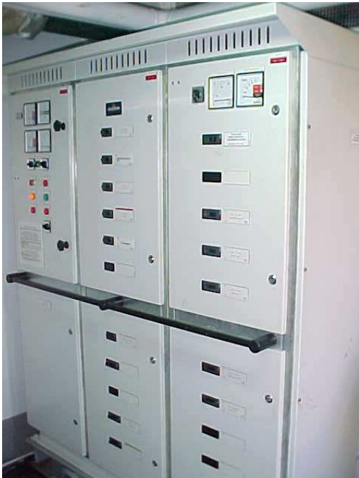
Fig. 5 - QEE de uma embarcação de apoio marítimo.
