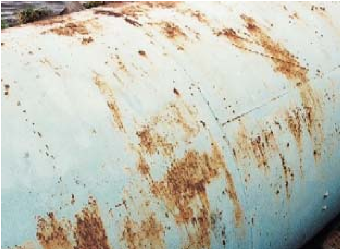
Figura 2 - Corrosão química Fonte – http://www.embratecno.com.br
