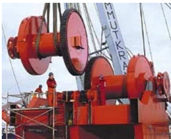
Figura 9 - Manutenção do guincho
