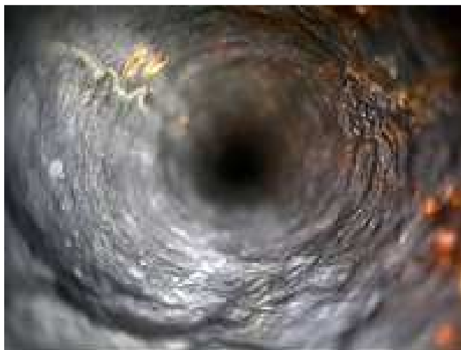
Corrosão de Ataque Geral
