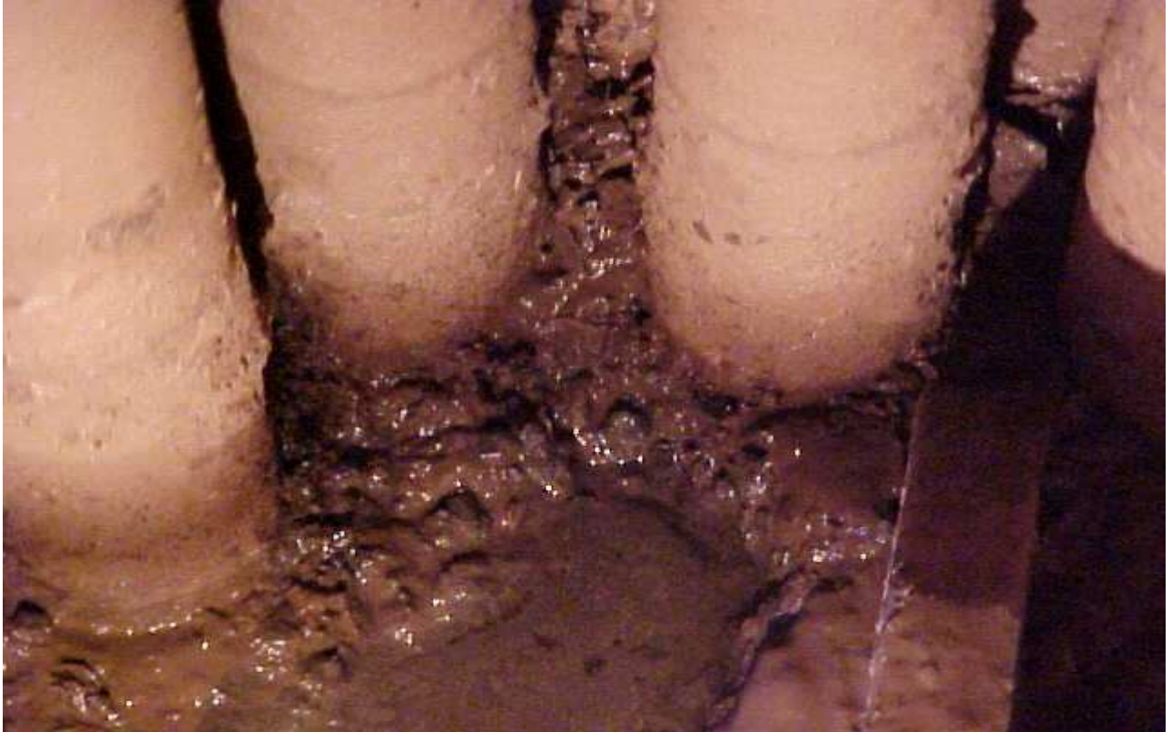
Incrustação, Depósitos e Corrosão – Fonte: Drew Ameroid Marine USA 1992
