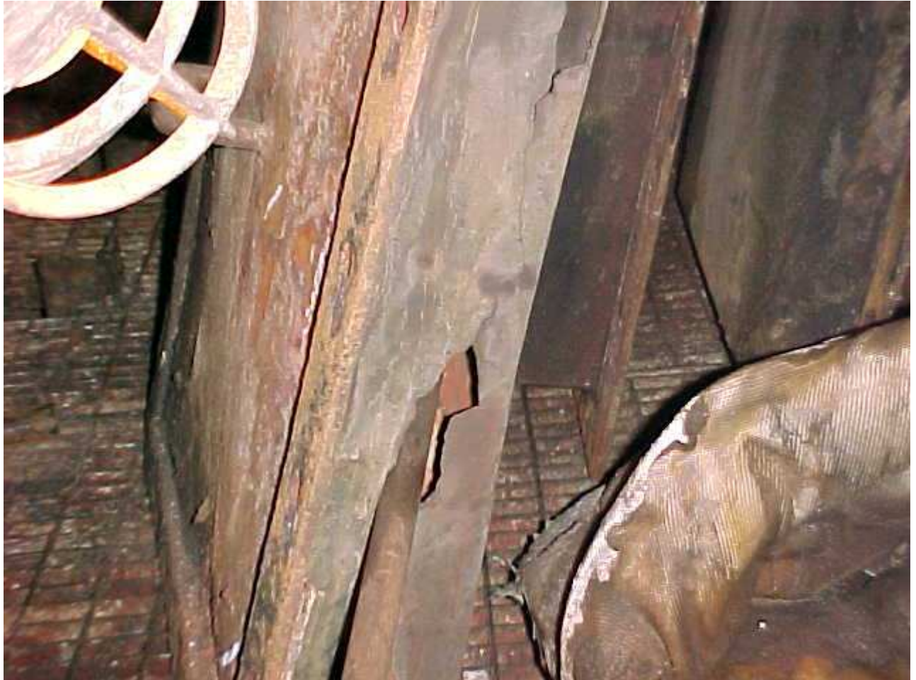
Corrosão na Chapa do Invólucro – Fonte: Drew Ameroid Marine USA 1992
