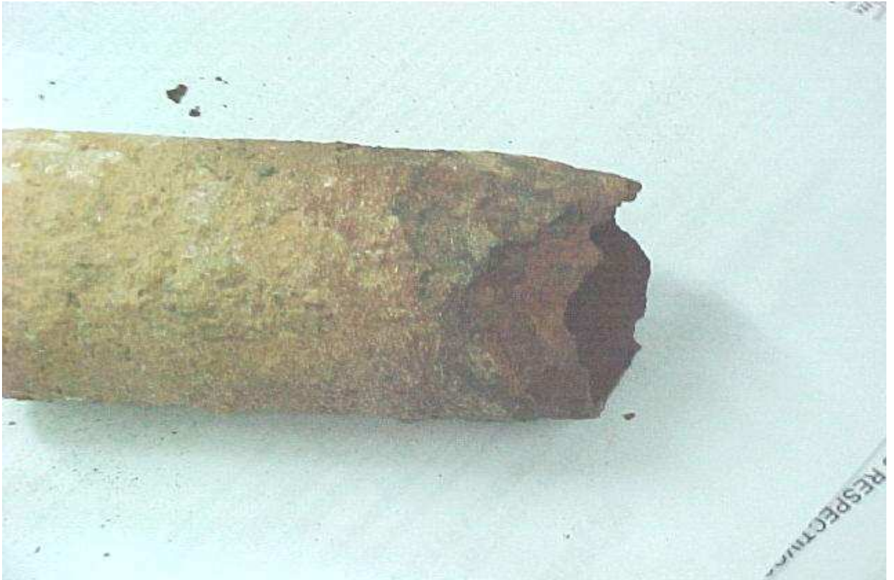
Corrosão nos Tubos, Área do Refratário
