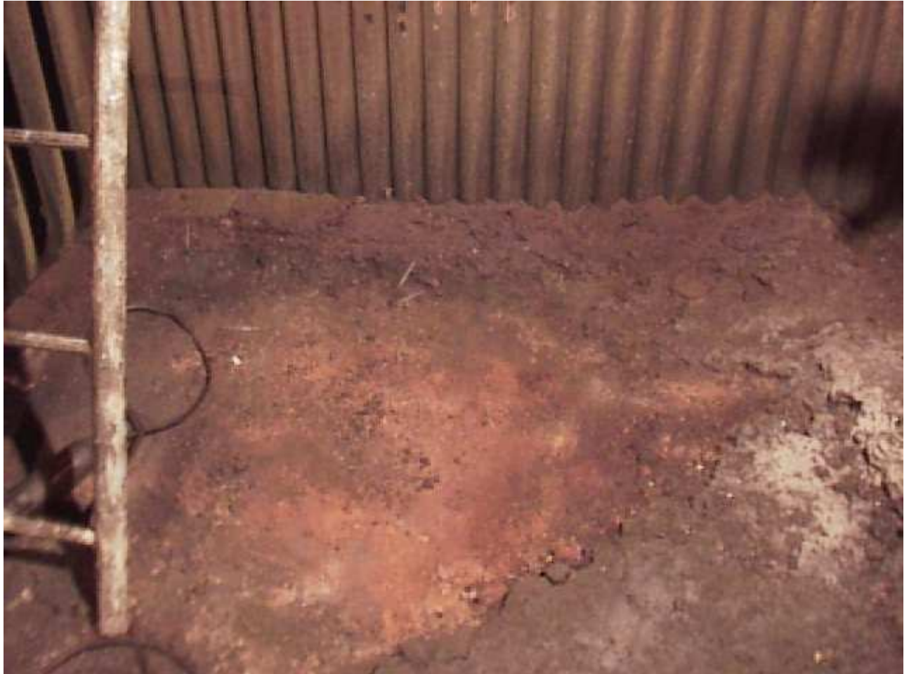
Avaria no Refratário por Derramamento de Óleo Combustível e, Possivelmente pela Mistura Refratário X Água. Fonte: Drew Ameroid Marine USA 1992
