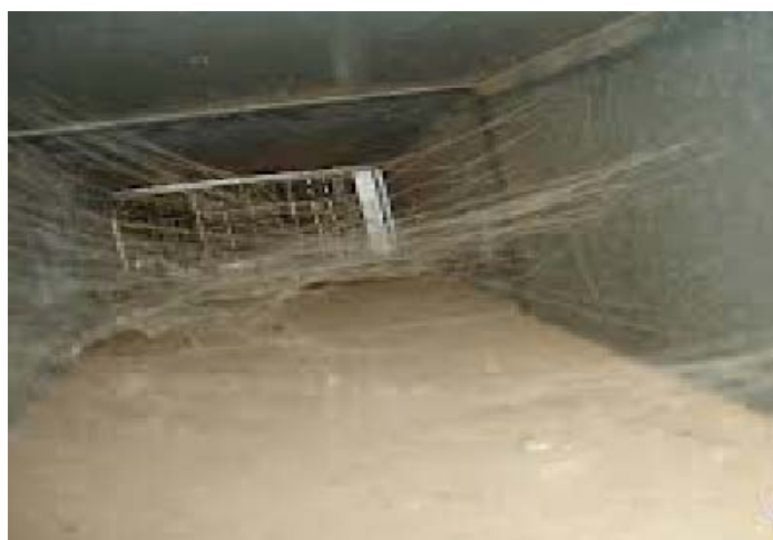
Figura 46 - Duto Sujo sem Manutenção B
