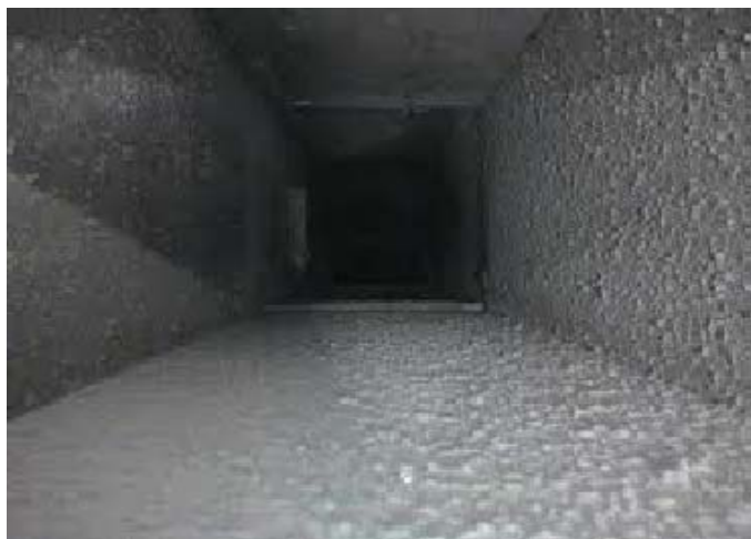
Figura 45 - Duto Sujo sem Manutenção A
