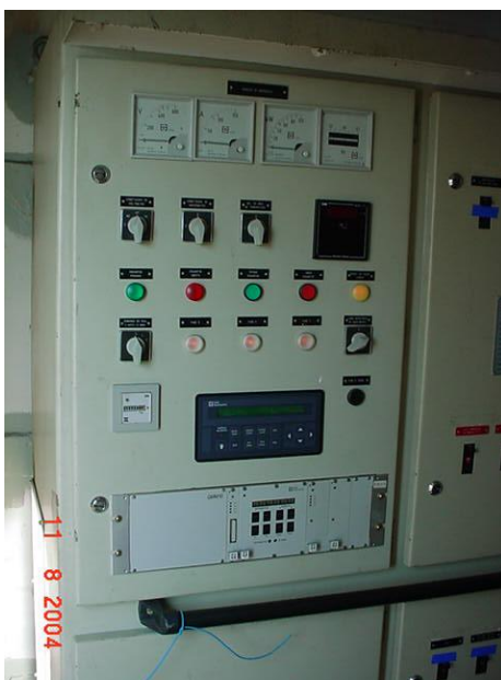
Fig 10 quadro elétrico de emergência
