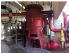
Fig. 12: Bomba de Incêndio
