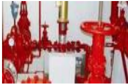
Fig. 7: Rede de Incêndio
