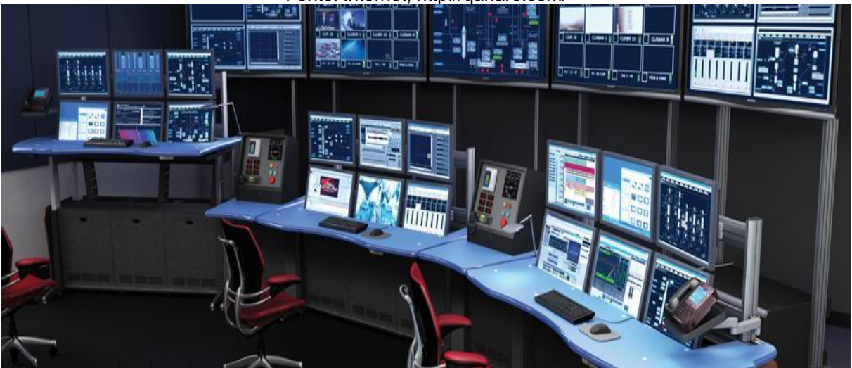
Figura 5: Sala de controle e monitorização de uma praça de máquinas, exemplo de SCADA.
