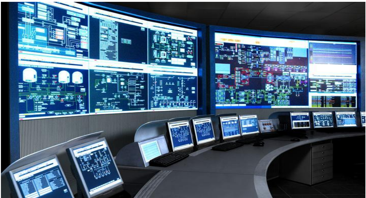
Figura 4: Sala de controle e monitorização de uma praça de máquinas, exemplo de SCADA.
