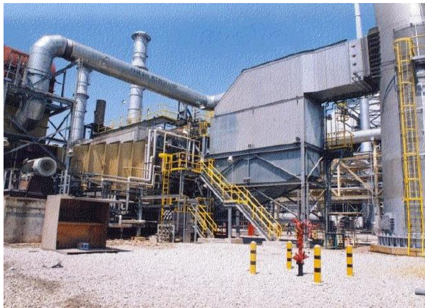
Figura 16 – Caldeira Exxon Mobil, antes da explosão
