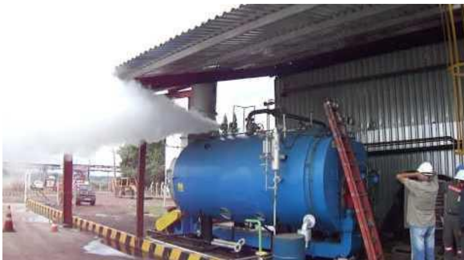
Foto 12 – Válvula de segurança operando em caldeira
