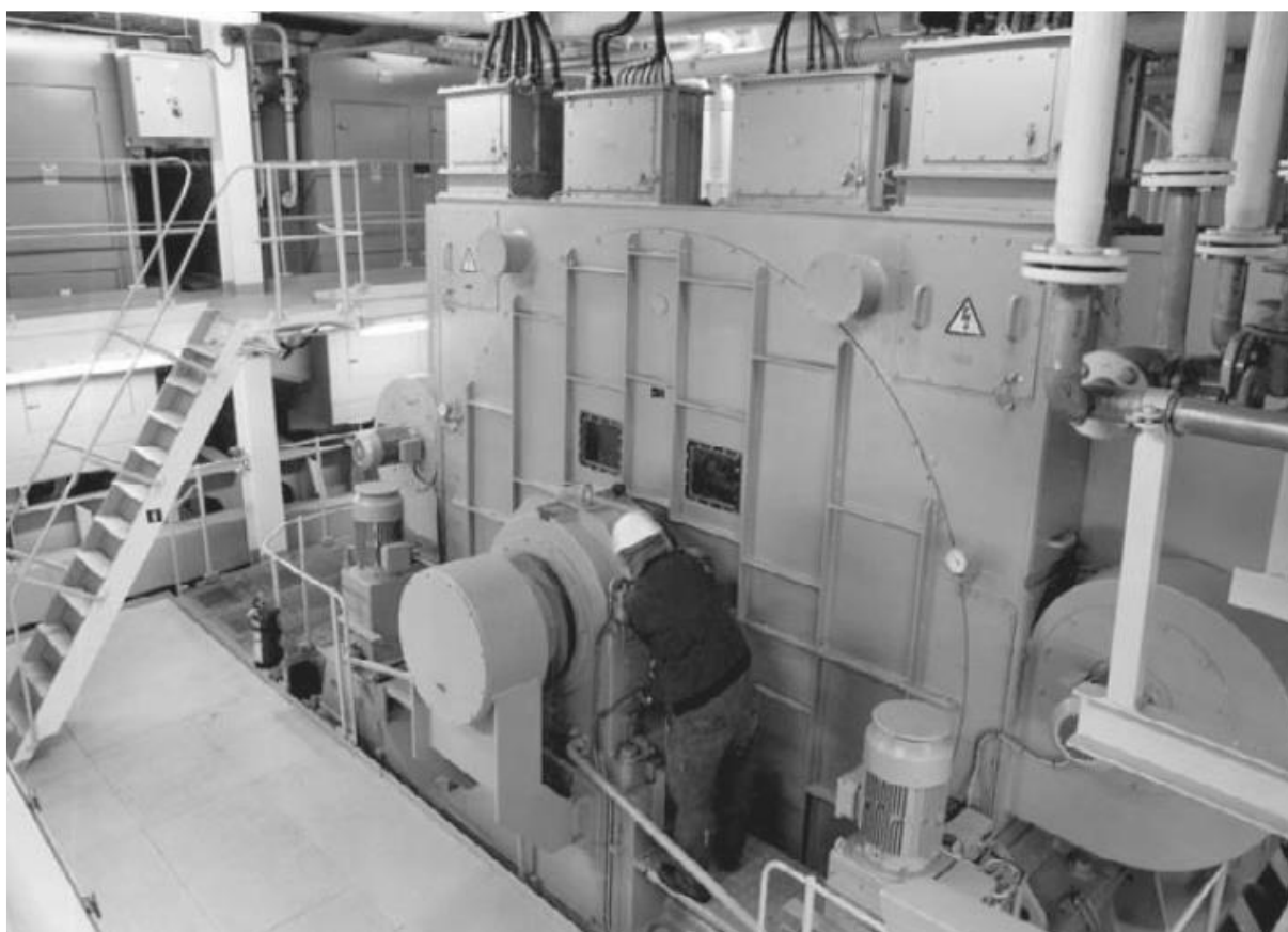
Figura 3 – Motor elétrico de propulsão
