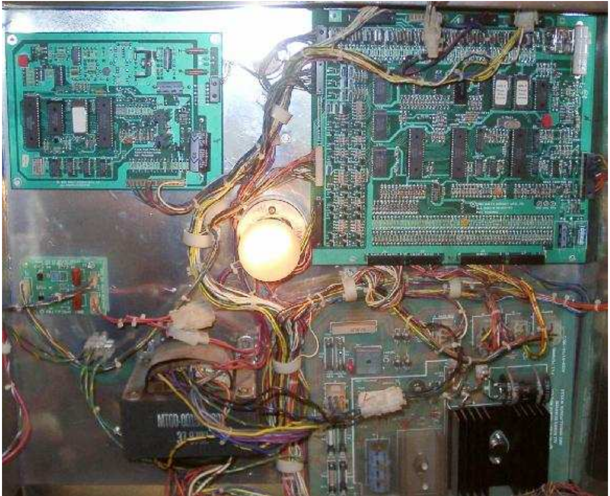
Figura 02. Exemplo de circuito eletrônico sem manutenção preventiva
