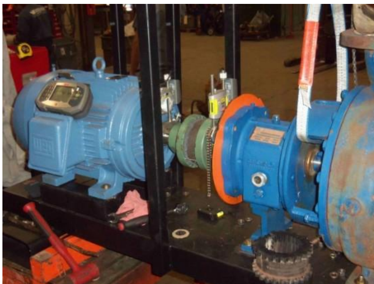
Fig.23: alinhamento de bombas
