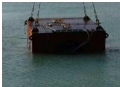
Figura 43 – Afundamento da estrutura
