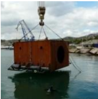
Figura 26 – Afundamento na água
