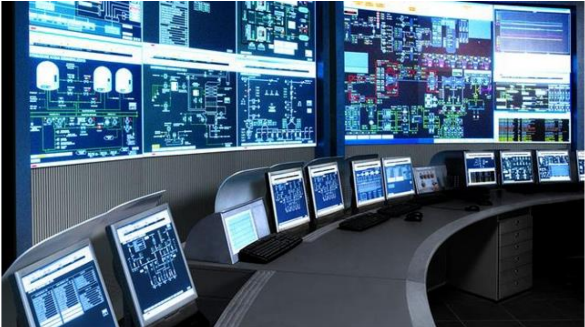
Figura 6 – Sala de Controle de uma Planta Industrial
