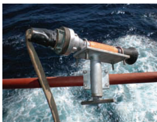
Figura 9 - Esguichos fixados nas varandas Fonte: OCIMF
