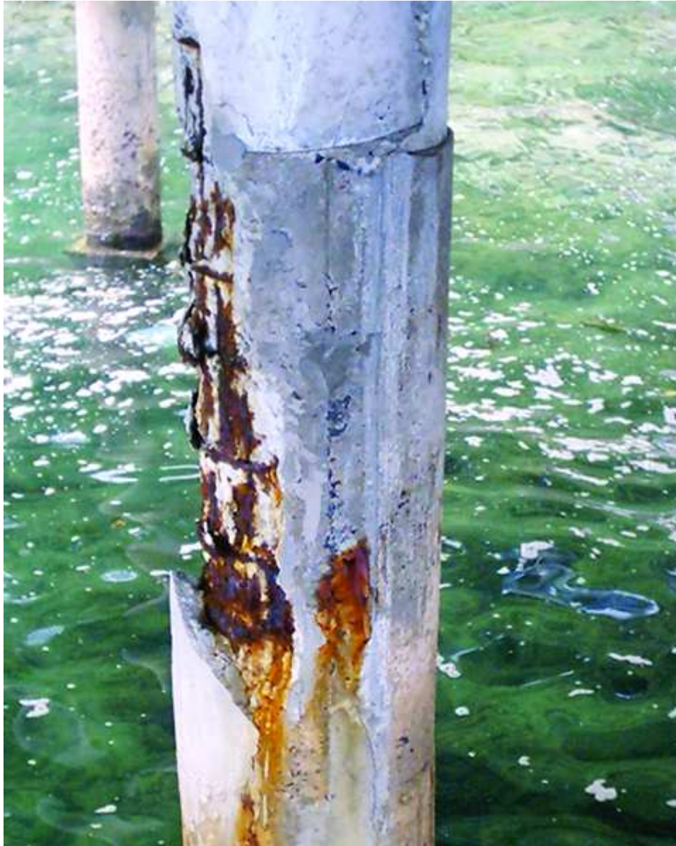
Figura 5 - Corrosão por fadiga devido à ação da água do mar
