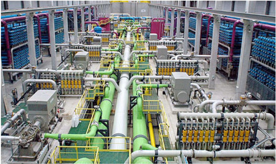
Figura 2 - Planta Industrial Osmose Reversa na Espanha
