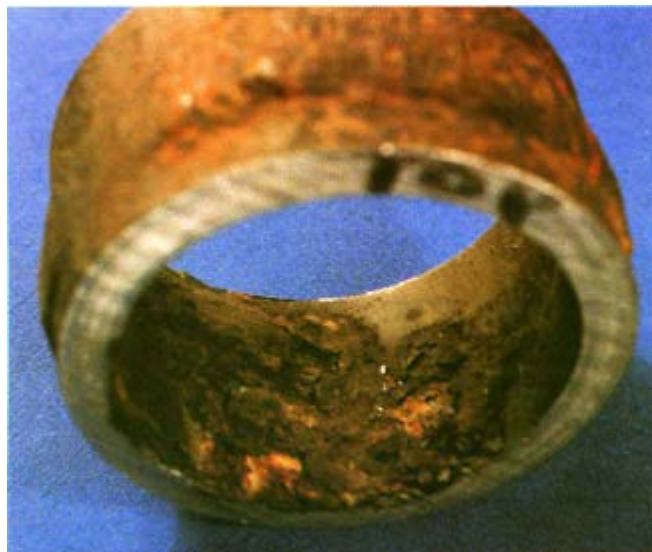
Figura 9: Corrosão ocasionada por baixo pH.
