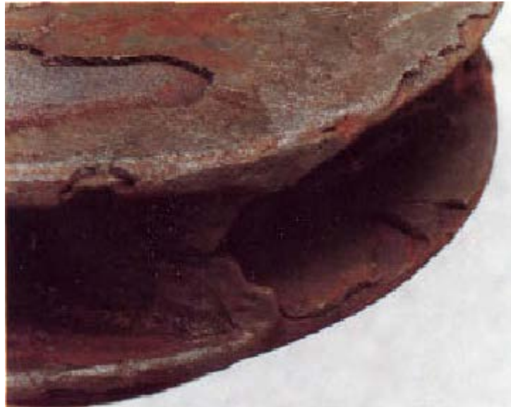
Figura 6: Corrosão por grafitação no impelidor de uma bomba de alimentação de água de caldeira.
