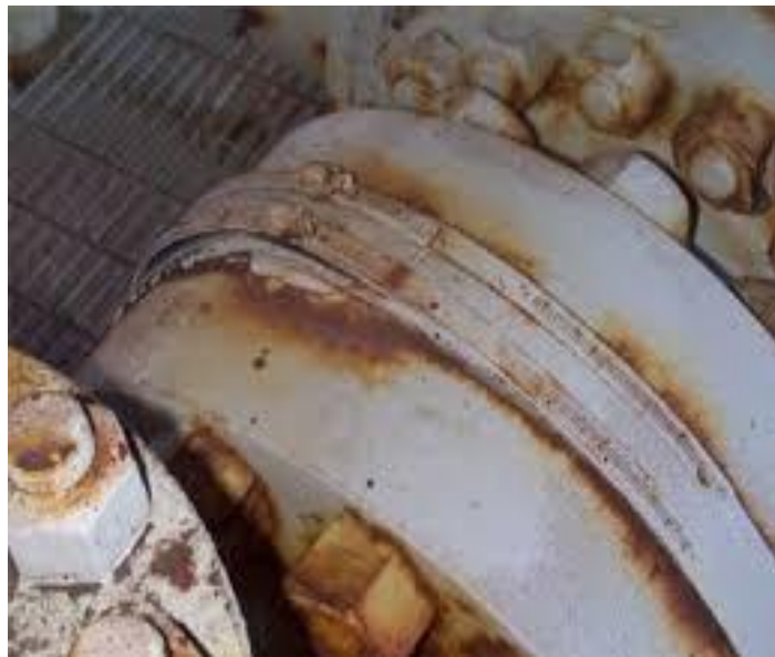
Figura 3: Corrosão em motores
