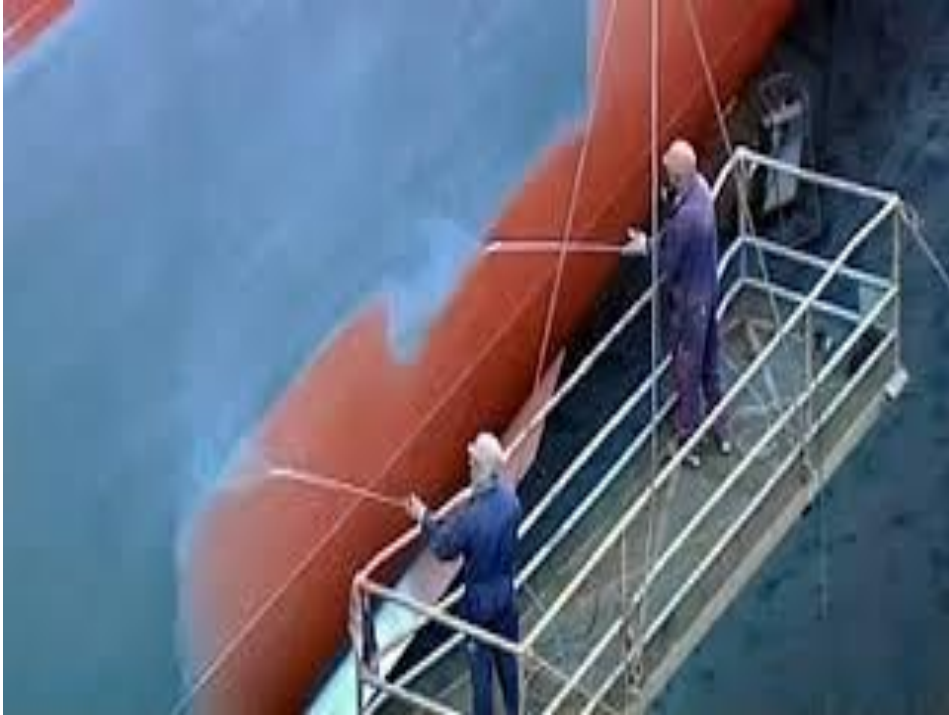
Figura 7: Proteção anti-corrosiva por pintura
