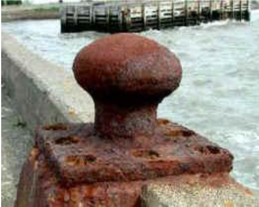
Figura 2: Exemplo de corrosão eletroquímica.
