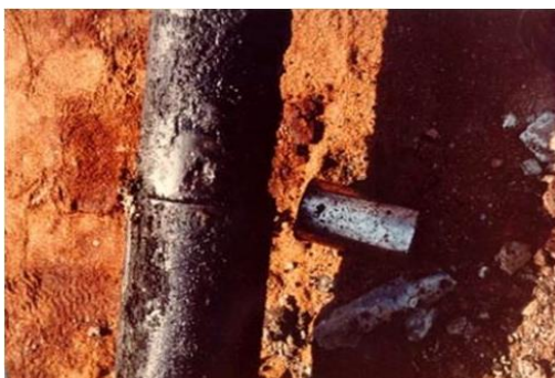
Figura 15: Corrosão localizada causada pelo solo
