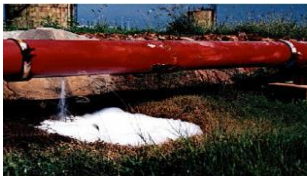
Figura 13: Biocorrosão em duto
