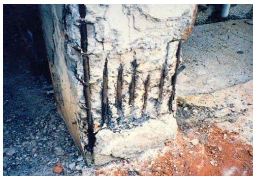
Figura 16: Corrosão em estrutura de concreto armado
