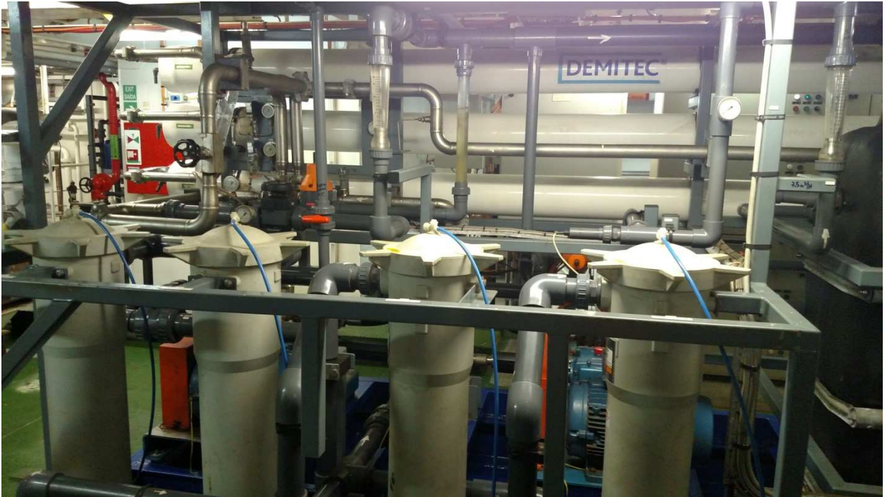
Unidade de Pré Filtragem
