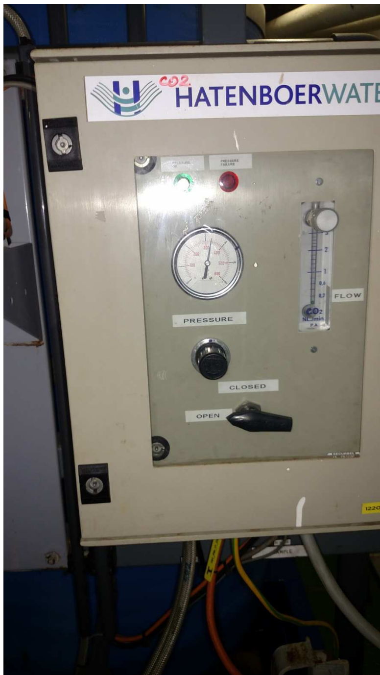
Painel do Sistema de Dosagem de CO2
