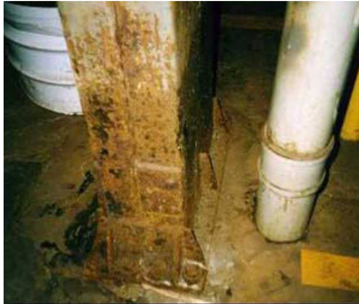
Figura 2: Estrutura metálica submetida a corrosão uniforme
