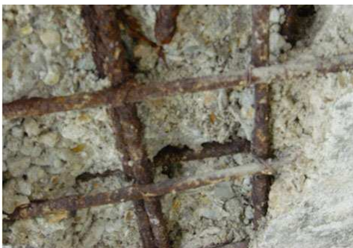
Figura 11: Estrutura de concreto que sofreu corrosão química
