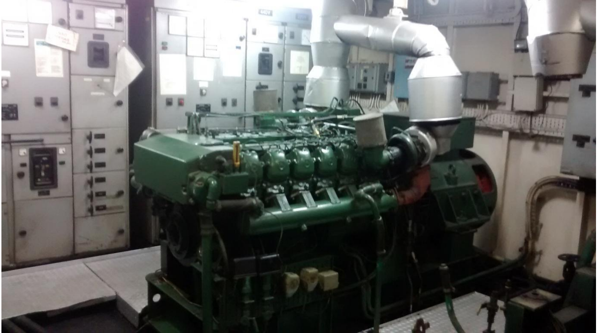
Figura 2: DGE e seu Quadro Elétrico de Emergência do NSS Felinto Perry
