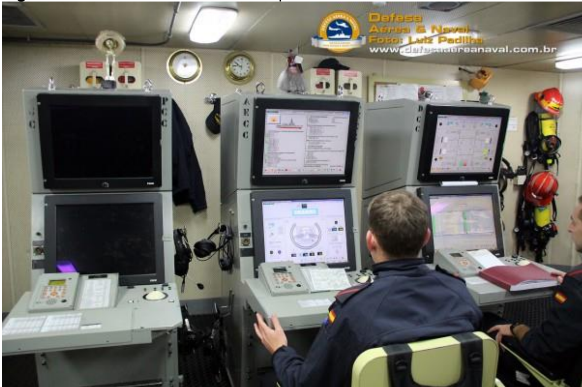
Figura 10: Central de controle de máquinas
