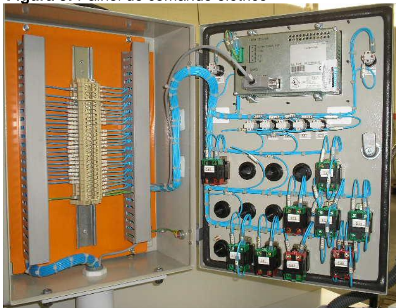
Figura 5: Painel de comando elétrico
