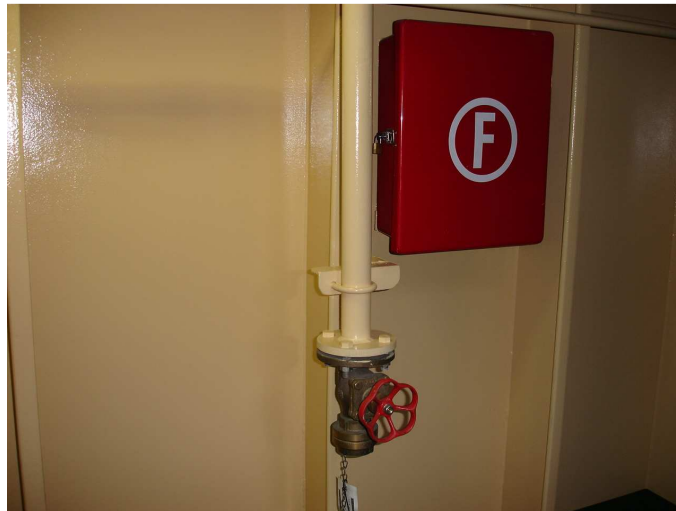
Figura 19 Posto de incêndio e tomada de incêndio
