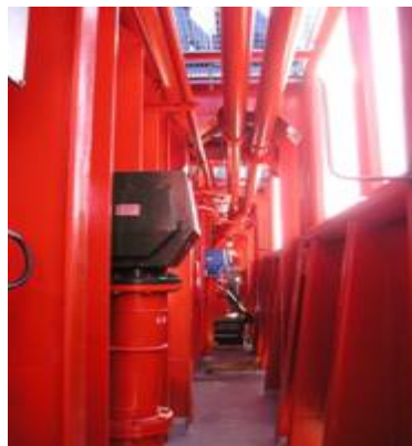
Figura 16: Suspiro de tanque
