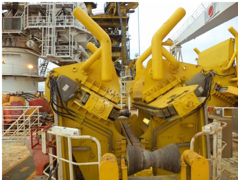
Figura 4: Tensionador do sistema de lançamento horizontal (HLS) do Skandi Vitória.
