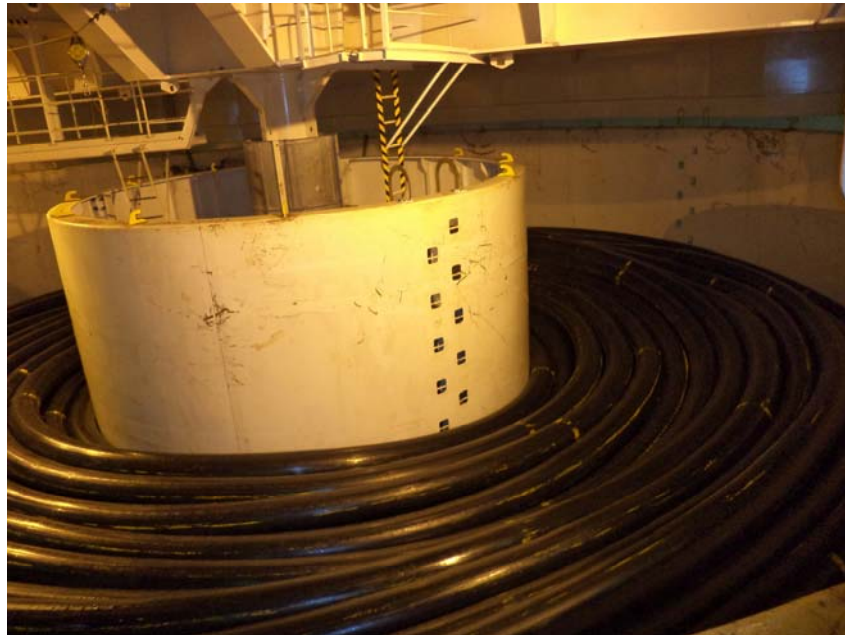
Figura 7: Cesta para acondicionamento das linhas.
