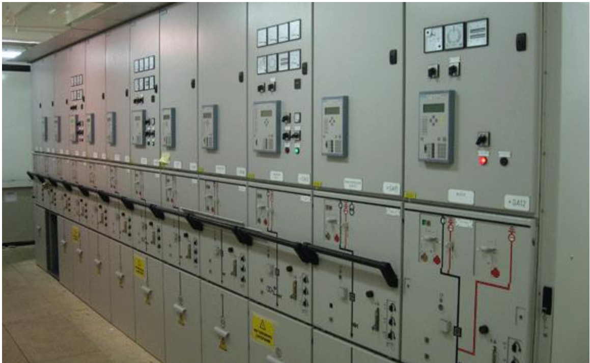
Figura 5 - Quadro elétrico principal de um navio.
