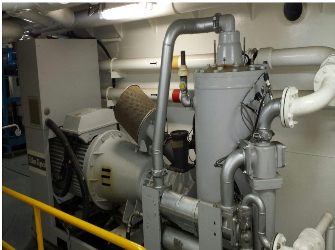
Figura 26: Compressor de ar
