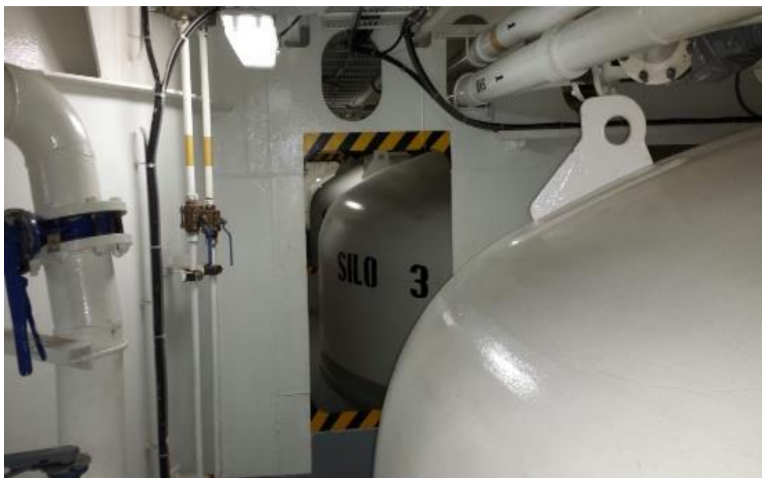
Figura 22: Silos para Granéis Secos
