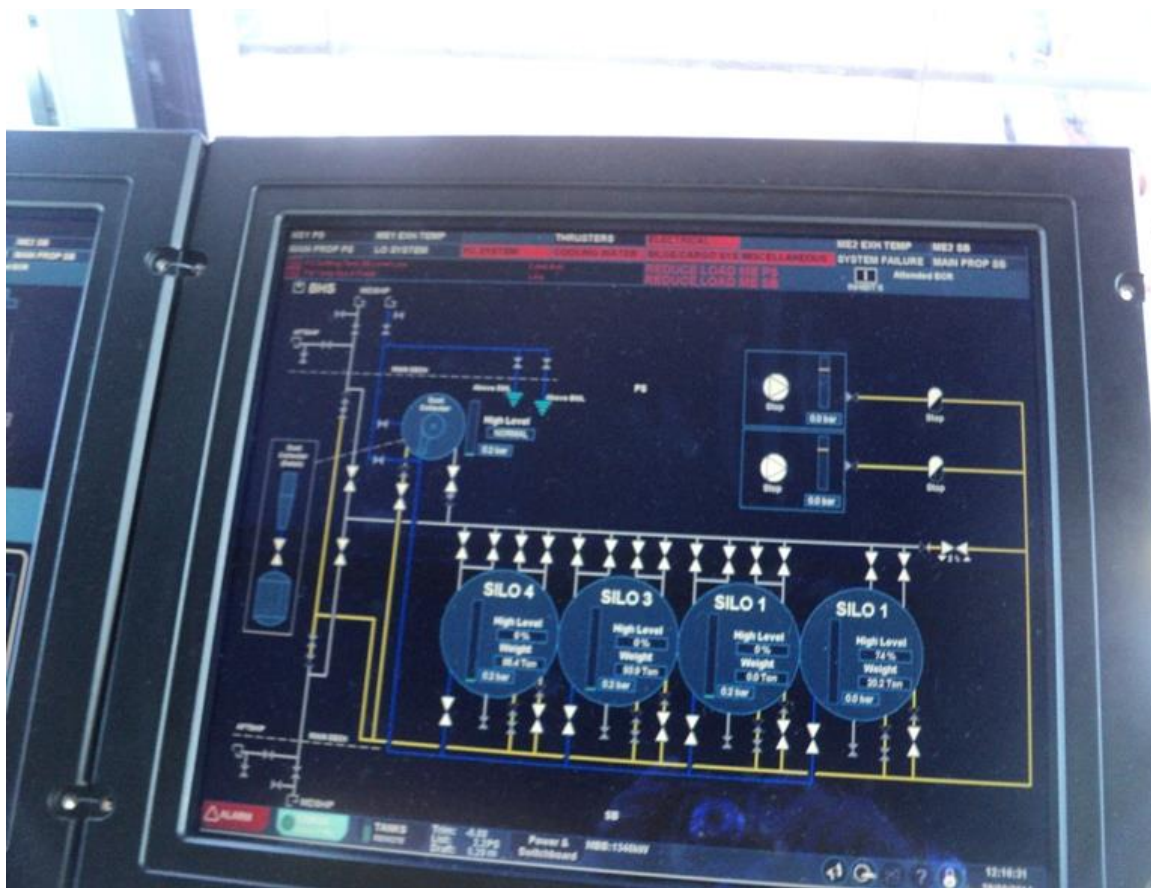
Figura 33: Monitoramento dos Silos (Graneis secos)
