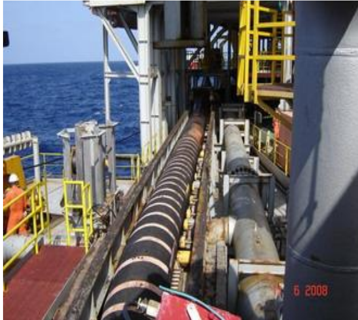
Figura 11 - Rampa de Armazenamento de Linha de Mangotes.
