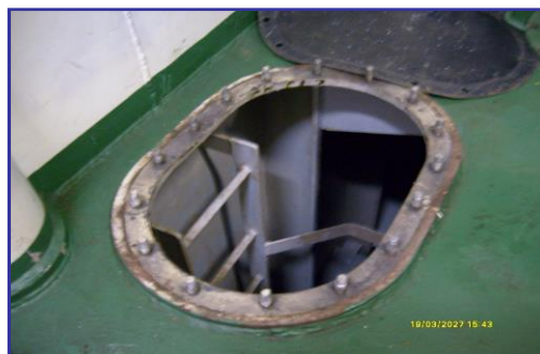
Figura 2 - Tanque de água doce.
