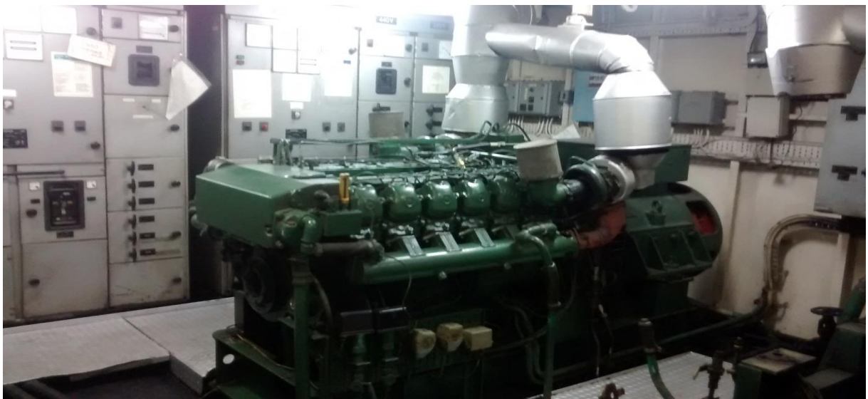
Figura 5 – DGE e seu Quadro Elétrico de Emergência do NSS Felinto Perry
