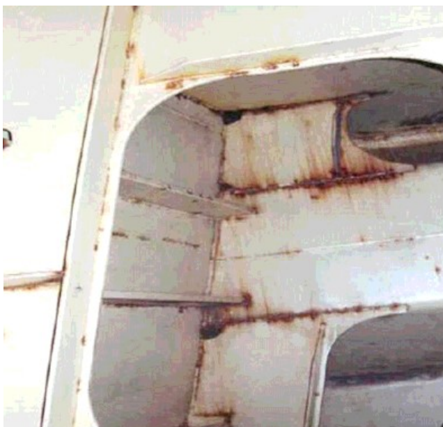
Figura 22 – Queda prematura do revestimento após 3 anos de serviço.
