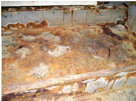
Figura 24 - Perda Estrutural devido a corrosão
