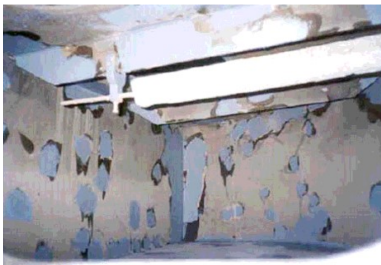
Figura 23 – Degradação prematura do revestimento (bolhas) após 5 anos de serviço, tanque mostrado após os reparos serem realizados.
