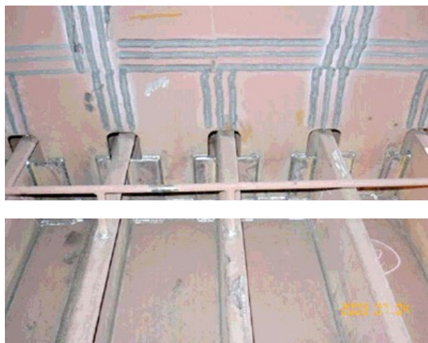
Figura 13 – Condição do tanque antes da aplicação de revestimento
