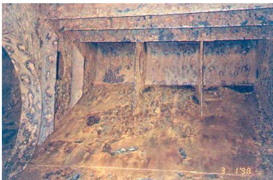
Figura 19 - Aplicação pobre de revestimento, condição do tanque de lastro após 13 anos (um tanque sob o convés de graneleiro é mostrado neste exemplo).
