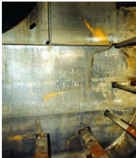
Figura 20 - Trinca por fadiga no chapeamento da caverna transversal de um tanque de lastro em um navio petroleiro de casco simples.
