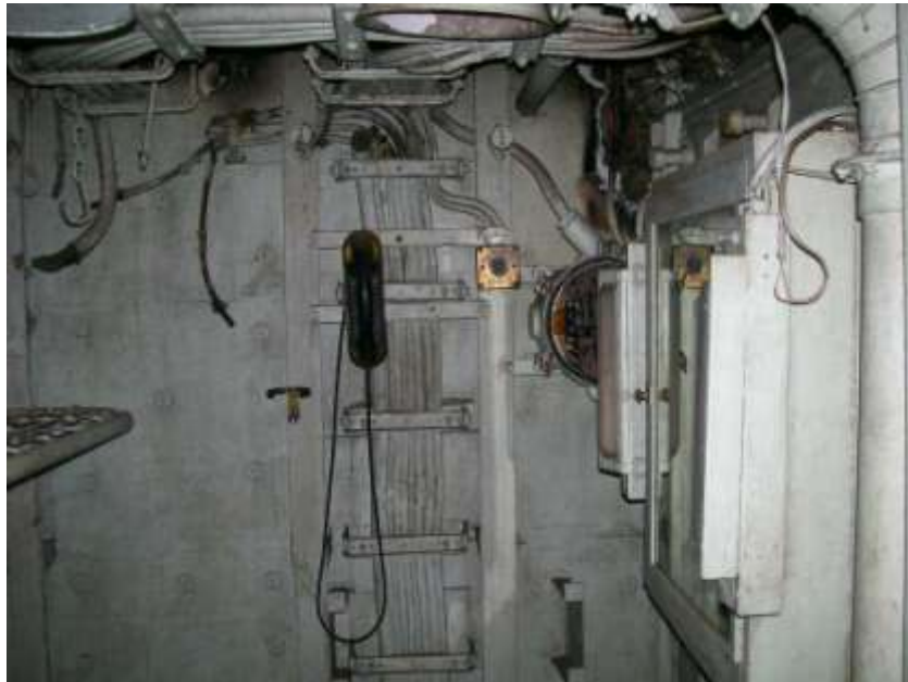
Ilustração 28 Dutos e fiação aparentes no costado. (fotografia de Jair Santos)
