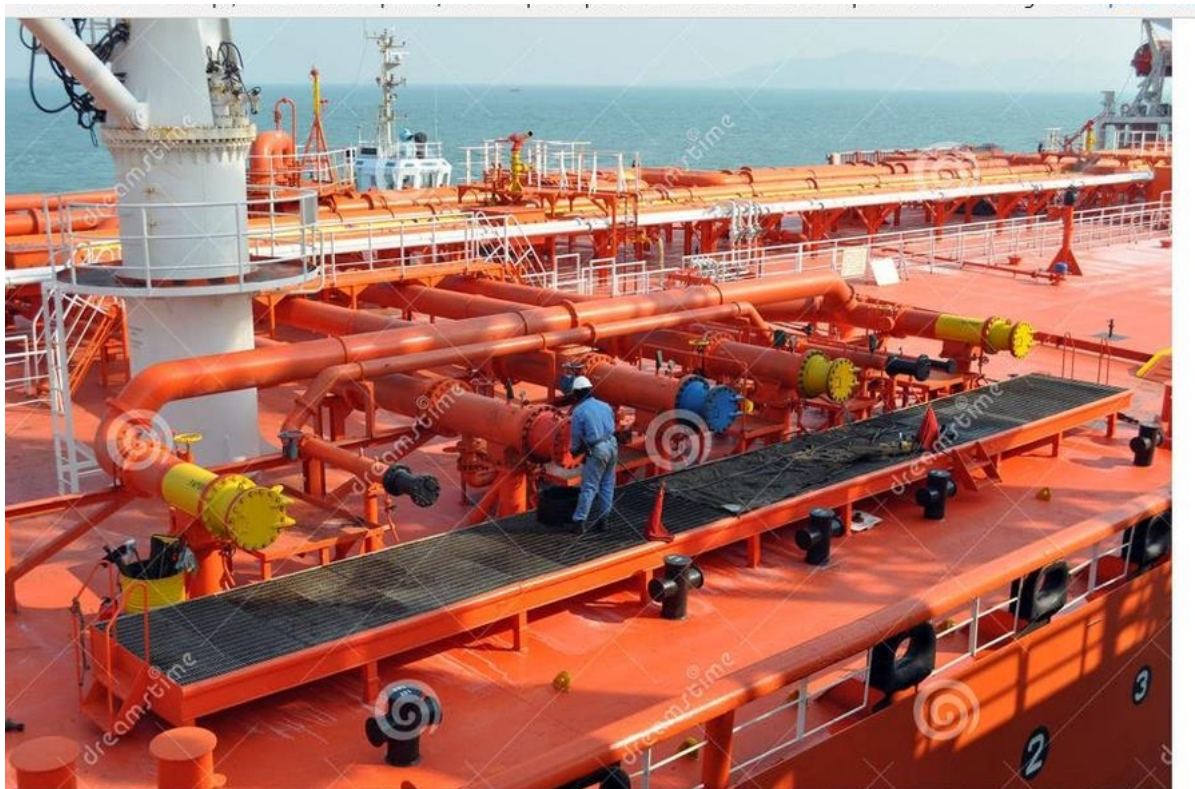
Figura 9 – Detalhe do manifold de carga, bandeja e suas tomadas
