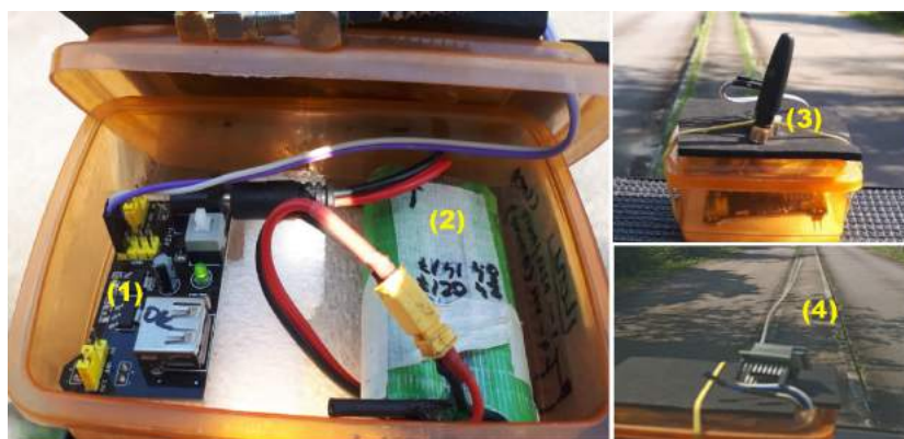
Figura 39 – Conteúdo da case dos rádios intermediários: (1) Fonte de Alimentação; (2) Bateria Li-Po; (3) Rádio LoRa; e (4) Rádio XBee.
