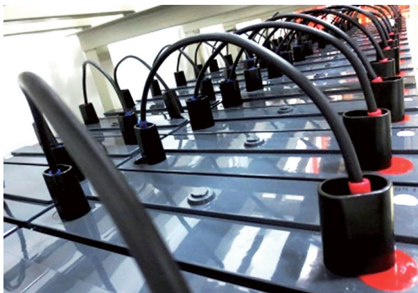
Figura 11 - Bateria e Acumuladores
