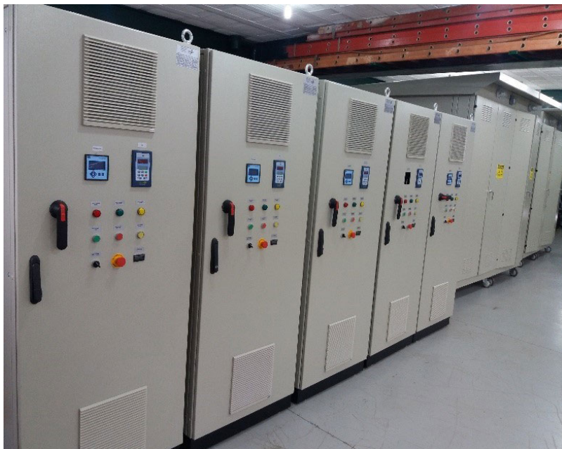
Figura 3 - Quadro elétrico principal
