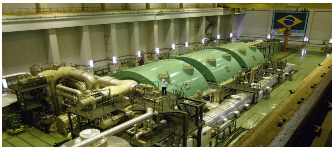
Figura 8 – Turbina de Angra 2
