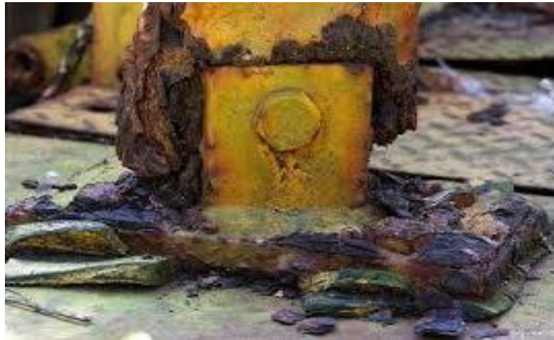
Figura 12 – Superfície Metálica Sofrendo Corrosão Atmosférica
