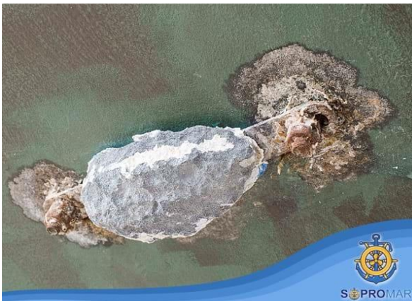
Figura 5 – Corrosão do Anodo de sacrifício
