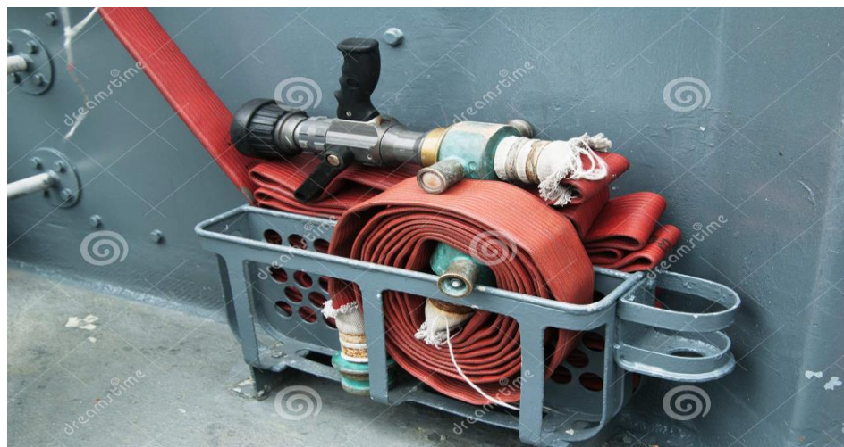
Figura 22: Mangueira de incêndio armazenada
