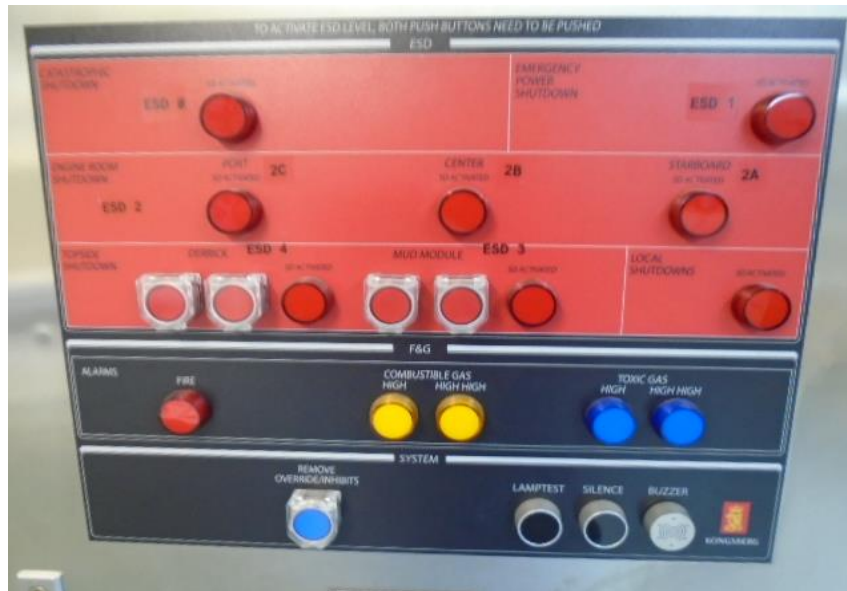
Figura 2 - Painel de Ativação ESD Nível 4
