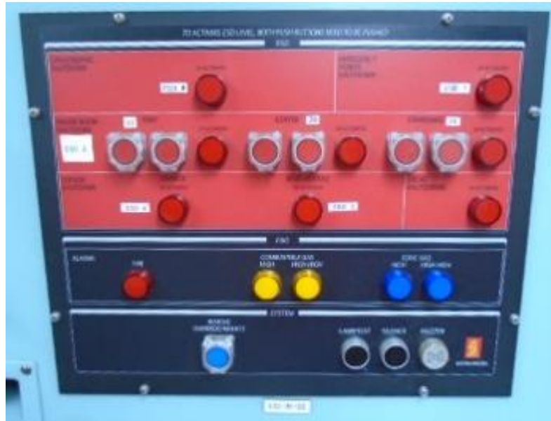
Figura 4 - Painel de Ativação ESD Nível 2A, 2B e 2C
