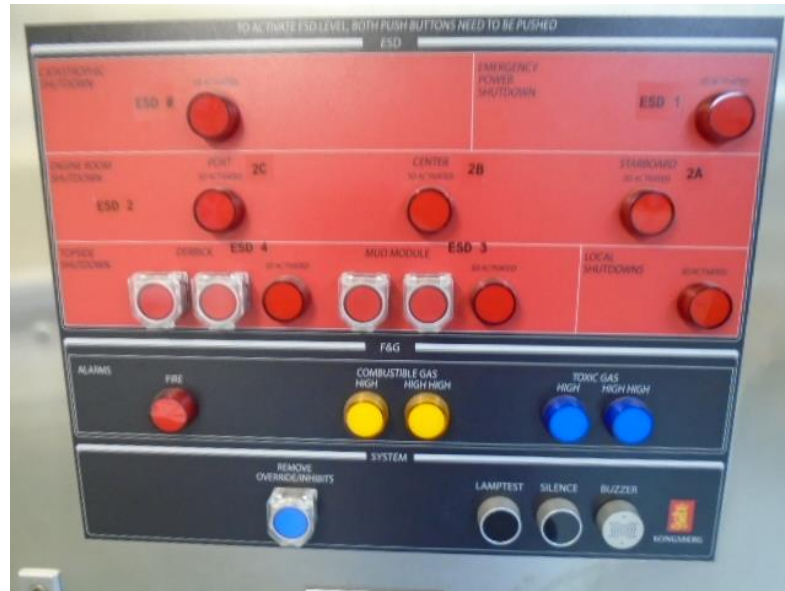
Figura 3 - Painel de Ativação ESD Nível 3
