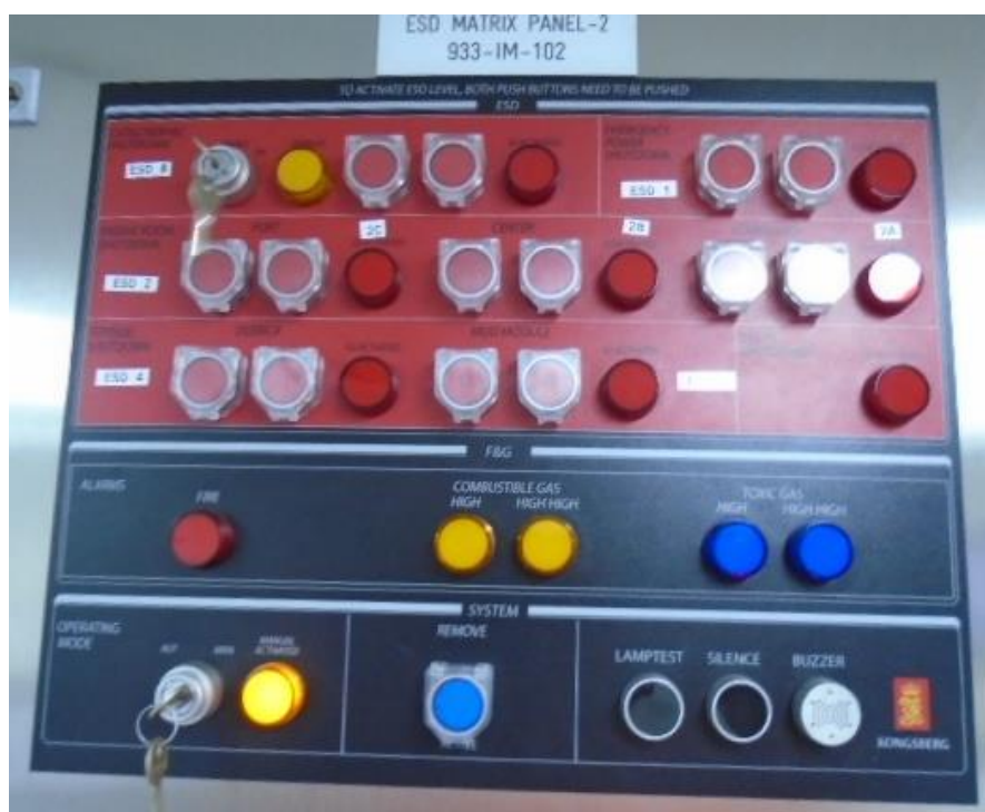
Figura 5 – Painel de Ativação ESD Nível 1
