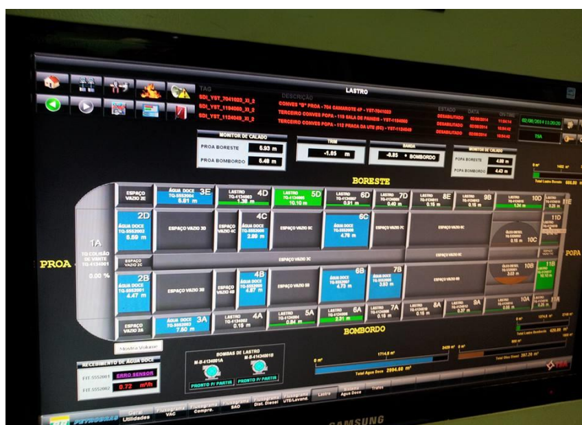
Figura 2 – Painel de tanques na sala de comando
